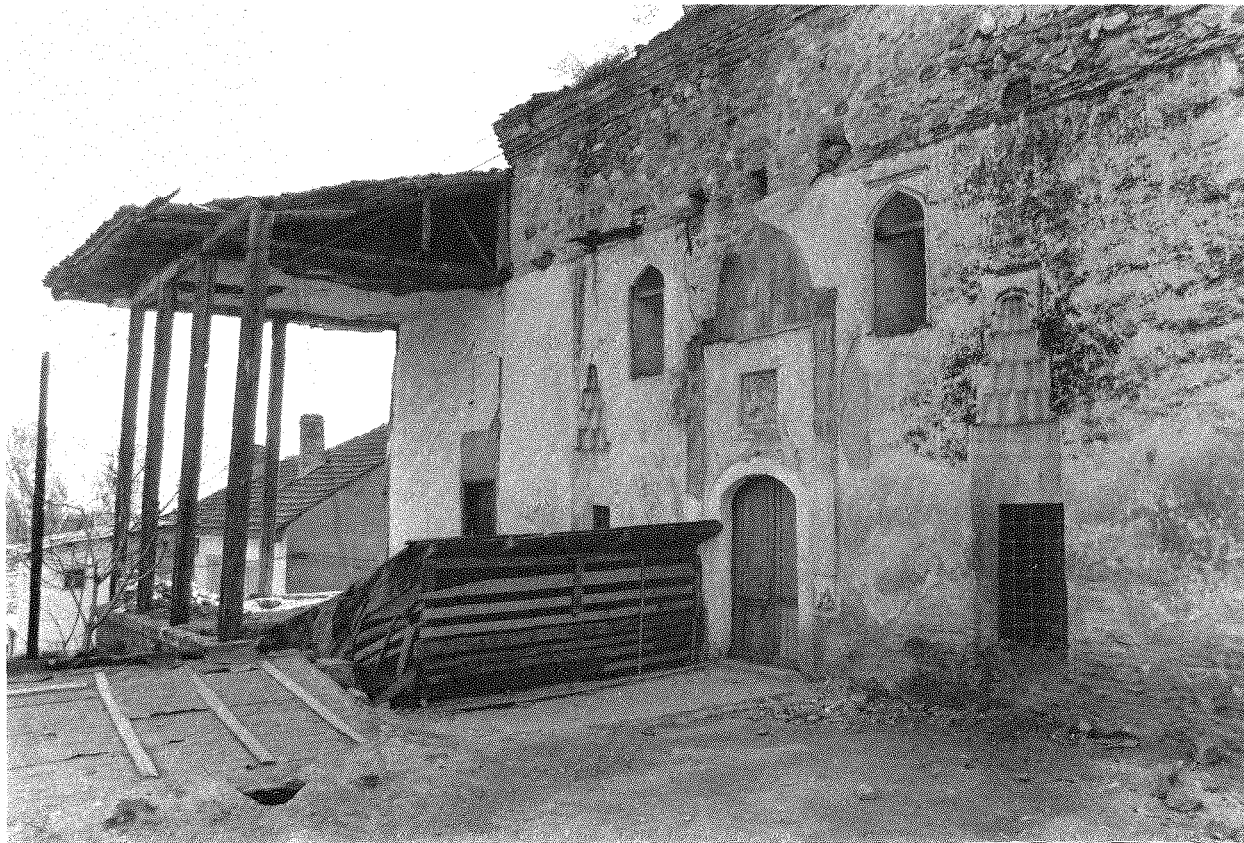
15 — Strumica, Orta Cami', the collapsed wooden portico. (1989).
